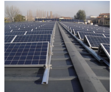
View of Manlleu PV
