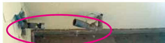
Abbildung 2: Nicht angeschlossene Wasserleitungen
