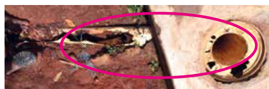
Abbildung 3: Defekte Leitung ohne die in der Spezifikation vorgesehene Überdeckung
